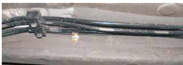
Рис.8 Газовый трубопровод, установленный на монтажных «пластинках»
